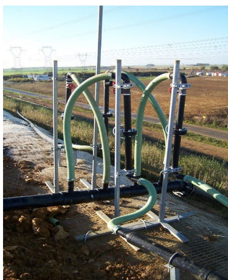
Photo 1 – Station de réglage puits biogaz
